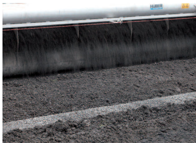
利用翻滚机进行污泥反混和污泥曝气
