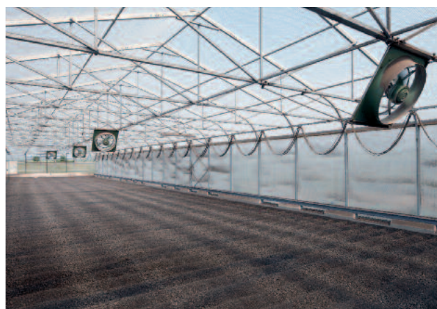
工艺鼓风机“推动”干燥空气贯穿整个大厅泥床
