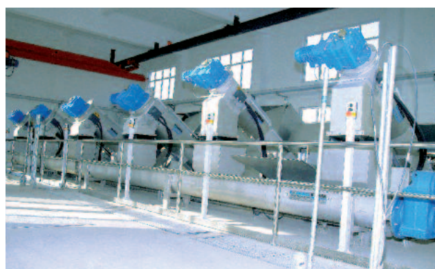
ROTAMAT® 膜格栅 RoMem 水渠安装，膜反应器前的过滤
