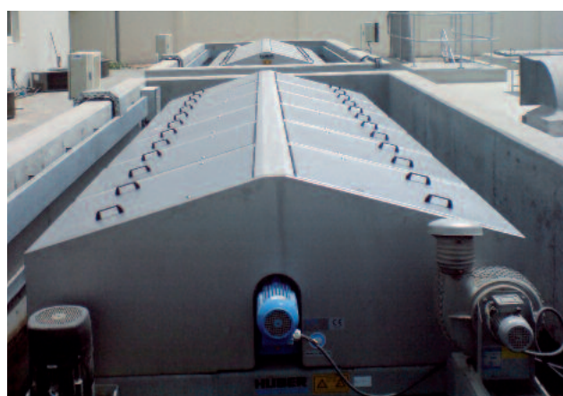
RoDisc® 转盘过滤器配置 20 张过滤盘, 安装在水泥池内
