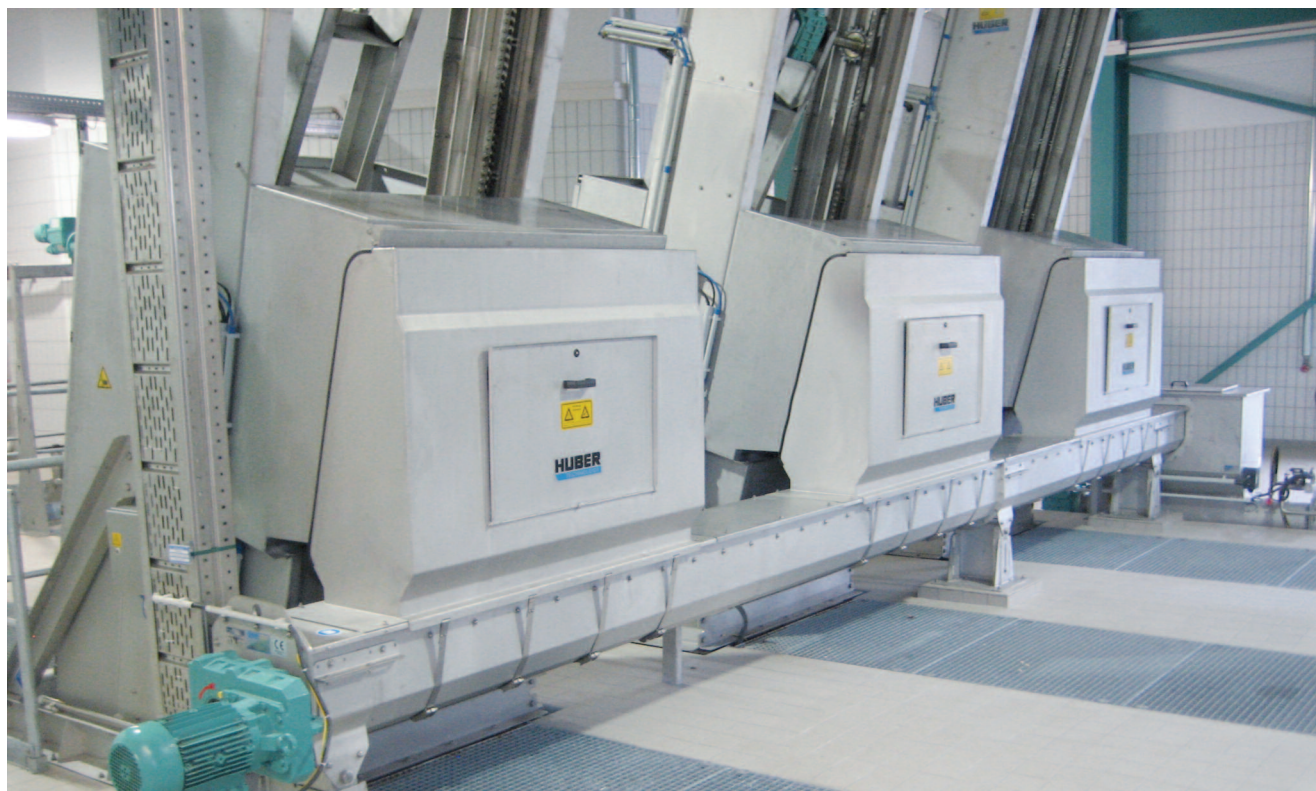
三台格栅将栅渣投入U型运输螺杆 Ro 8t
