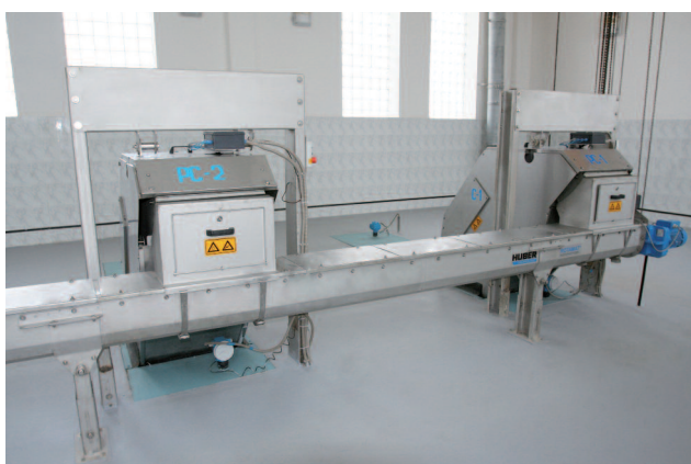
两台平行运转的格栅将栅渣投入U型运输螺杆
