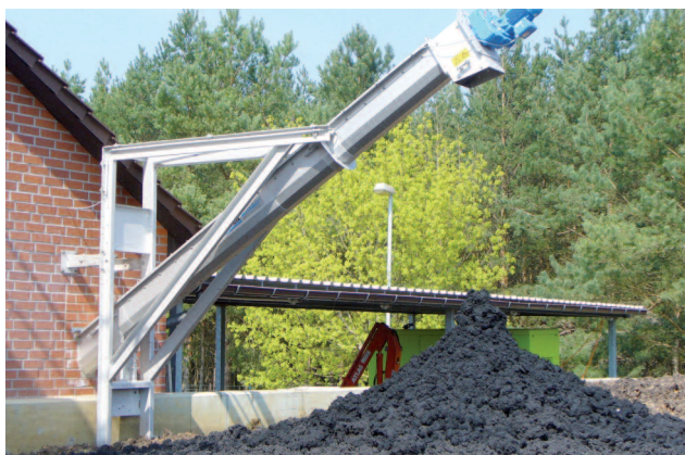
HUBER ROTAMAT® U型运输螺杆Ro 8t 安装在污泥脱水机之后
