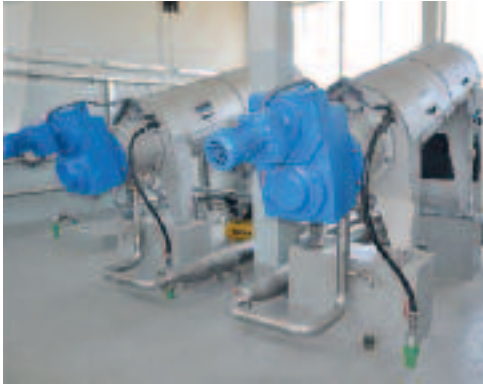
RoS 3Q 型螺压脱水机 – 两台平行安装
