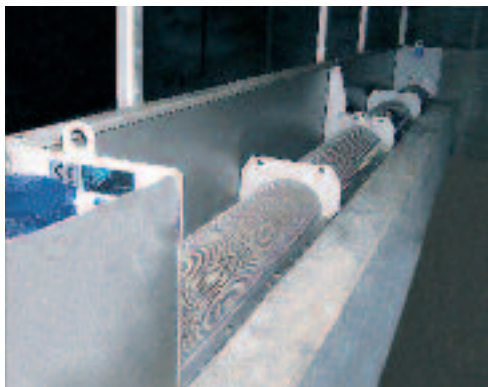
RoK 2: 安装在溢流堰前的初期雨水/混合污水过滤装置
