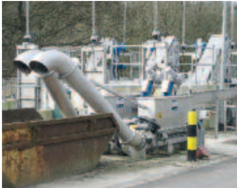
栅渣运输水槽进料系统和高效栅渣脱水
