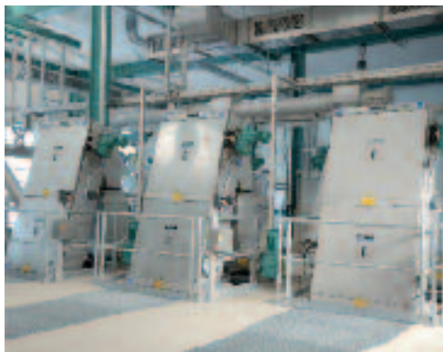
耙齿回转栅 RakeMax®: 结构坚固, 运行可靠
