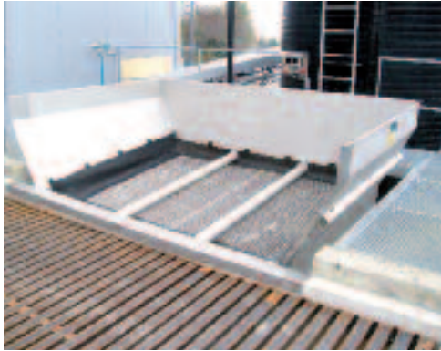
坚固耐用: 简单可靠的沉沙接收系统
