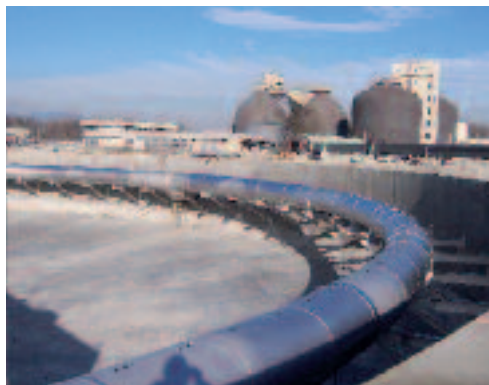
HUBER 水下排液管,最佳的潜水式排液系统
