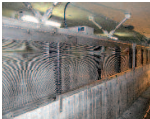
安装在溢流堰上的水平初期雨水/混合污水过滤装置
