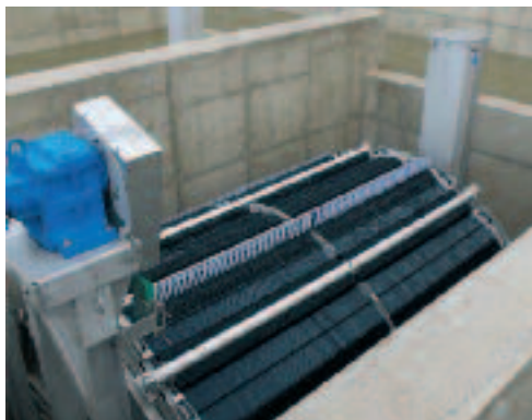
VRM® 30 – 设备安装在—市政污水厂的膜池内
