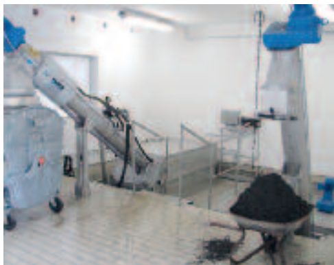
洗砂器内置在沉砂箱体
