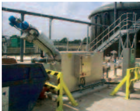
粪便污泥接收站 – 室外安装的污泥过滤装置
