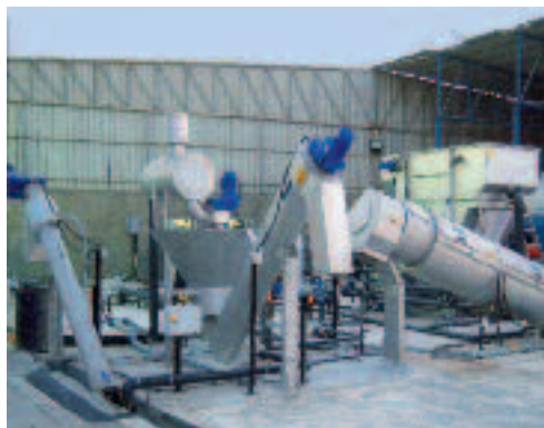
阿联酋炼油厂污水污泥处理
